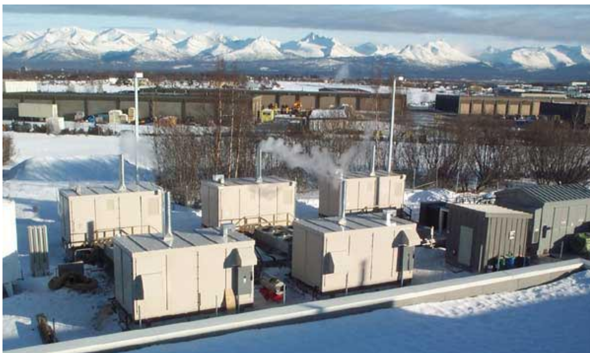
5 modułów PC25 z ogniwami paliwowymi zainstalowanych w Anchorage na Alasce dla urzędu pocztowego. Źródło: Fuel Cell Today 173 .
