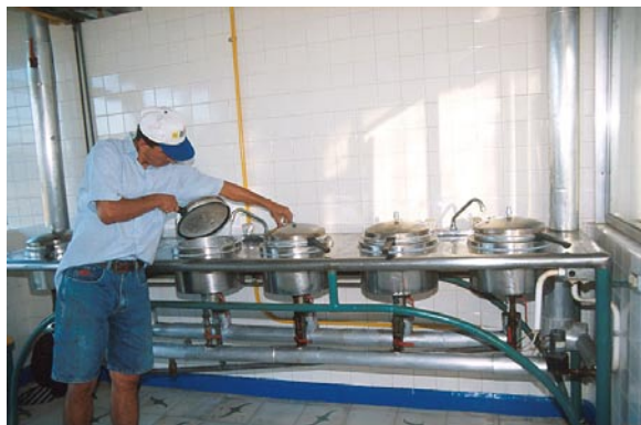
Kuchnia w Gaviotas wykorzystująca energię słoneczną. Źródło: Luis Guillermo Camargo 62 .
