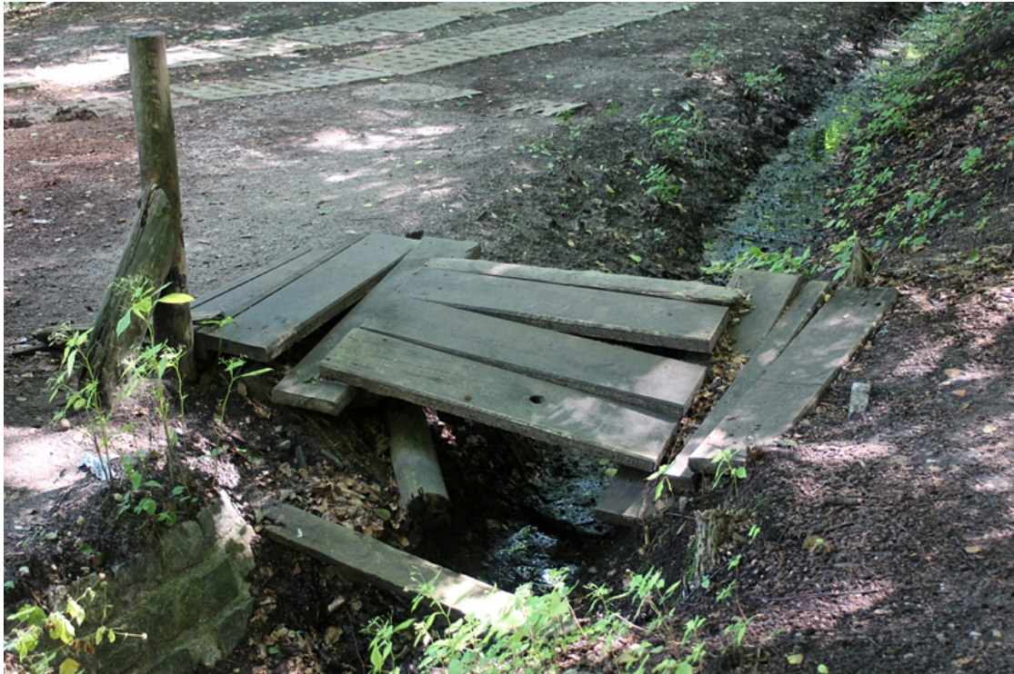
Zrujnowana kładka u dołu doliny Potoku Grodowego, która wymaga naprawienia.
