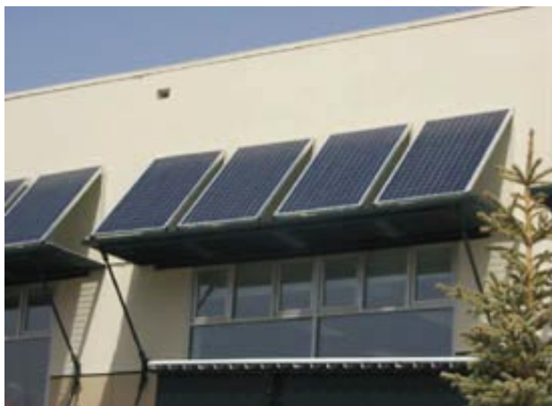
Moduły PV zainstalowane na budynku firmy Patagonia w Reno, USA. Źródło: Reno News and Review 125 .
